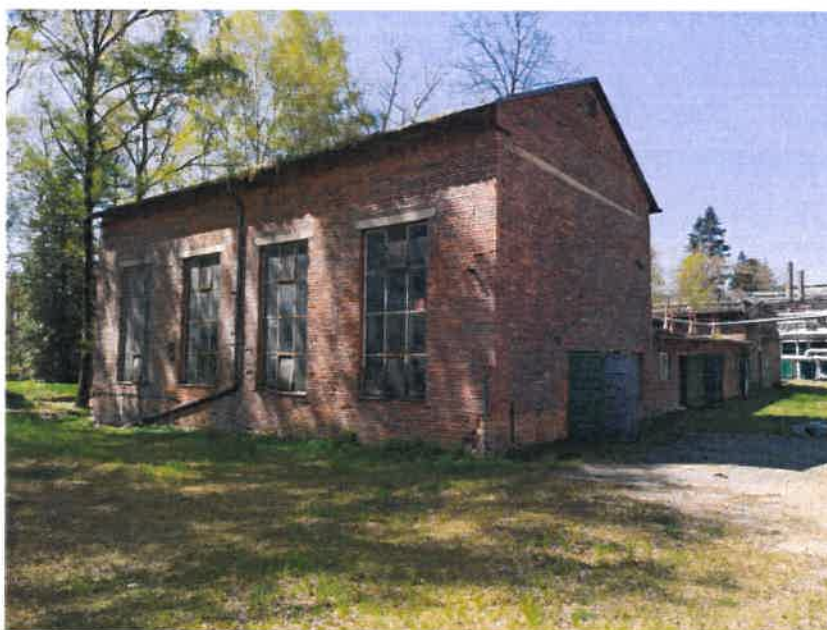
Stavba filtrační stanice na pozemku par. č. 1522/10 v k.ú. Lazy u Orlové
