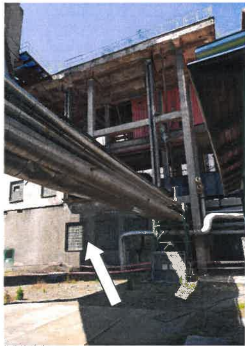
Místo rozdělovačů pod konstrukcí elektroodlučovačů
